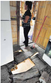
Martina Rodríguez aún no tapa el agujero que los ladrones dejaron en el piso de su casa de cuatro...
